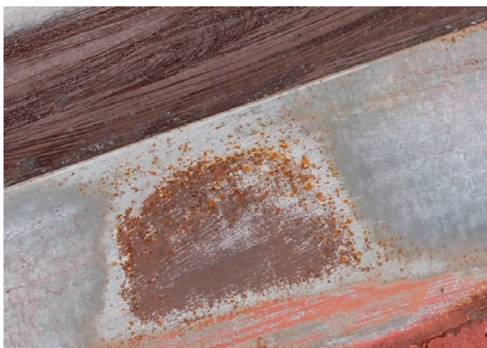
Korozi napadený pozinkovaný plech
