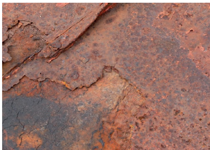
Hloubková koroze plechové krytiny
